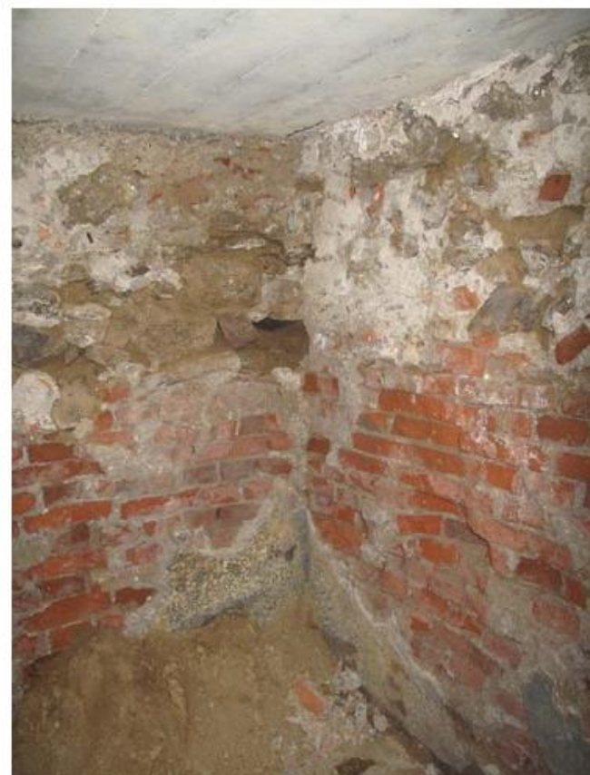
Degradované zdivo v podzemí.
