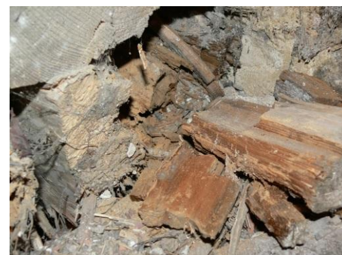
Destruovaný prvek krovu.
