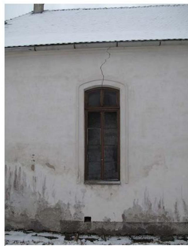
Trhlina v severovýchodní části.
